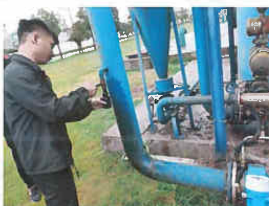
厂区地下水监测井 (☆1)
